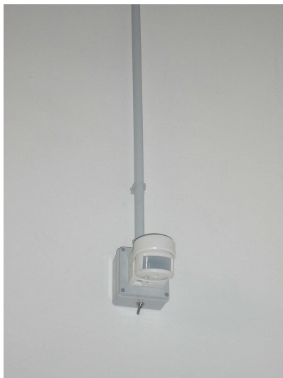
fig. 4: Dispositivo rilevatore ad infrarossi a montaggio ultimato.
